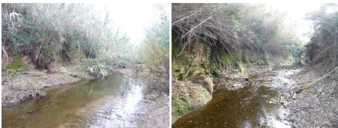
Figure 55 : Sur la Gisclé à gauche, et le Bourrian à droite, berges érodées et surmontées d'un merlon
